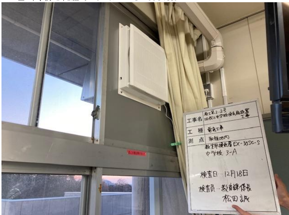
△ 中学校 3年A組 換気扇 三菱電機 EX-30SC-S
